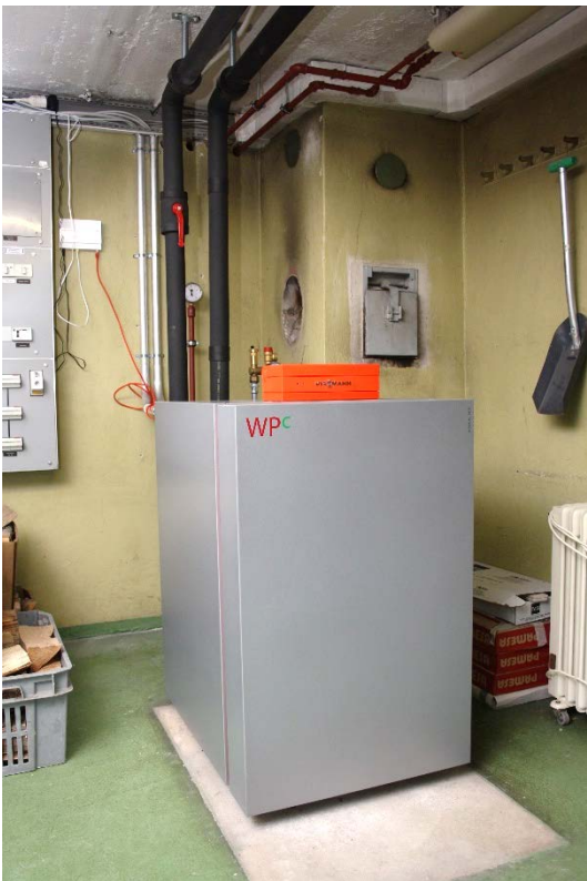
Die neue Sole/ Wasser- Anlage an Stelle des Stückholzkessels
