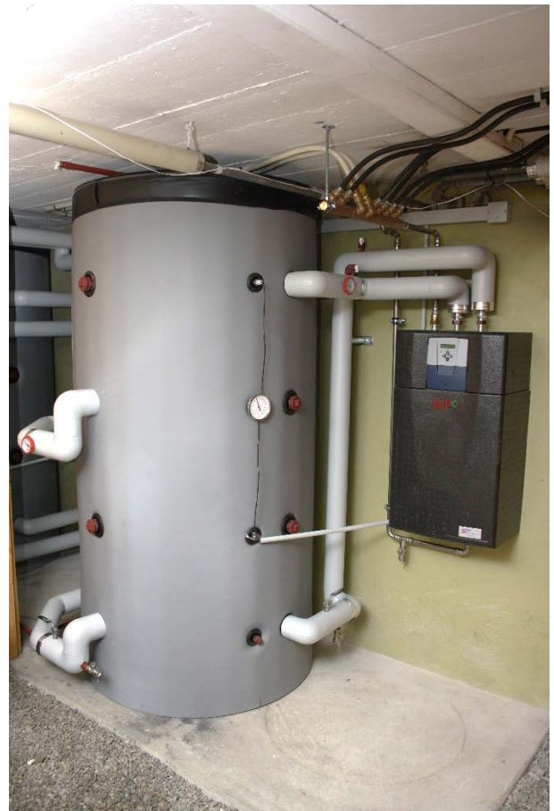
Frischwassersystem und Pufferspeicher
