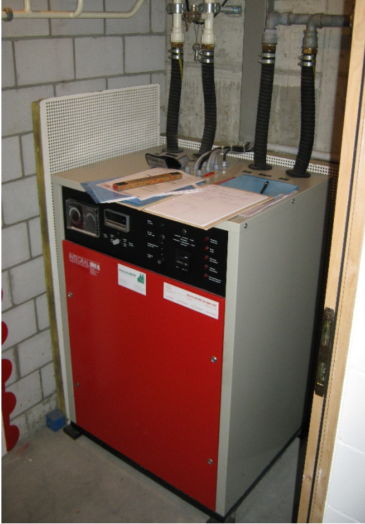
Die alte Grundwasser- Wärmepumpe
