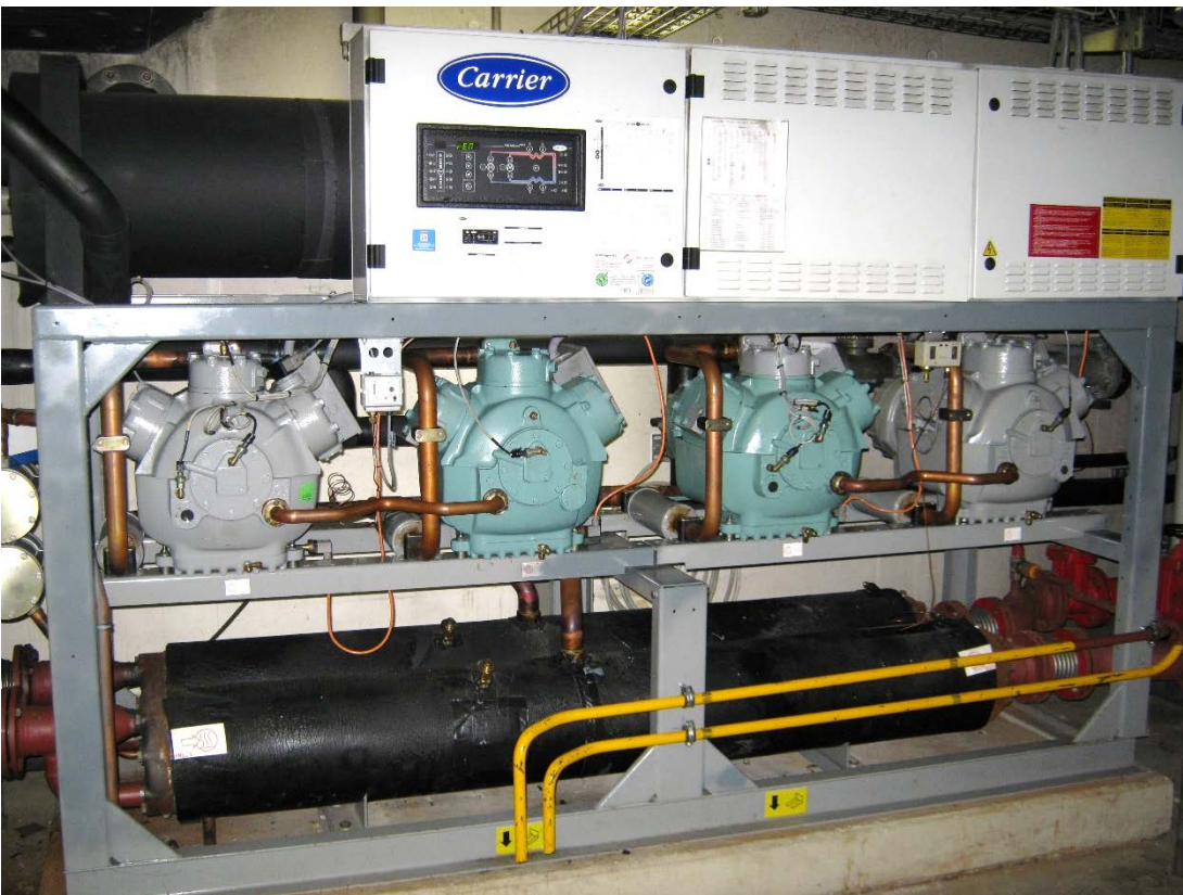
Die alte Wärmepumpe
