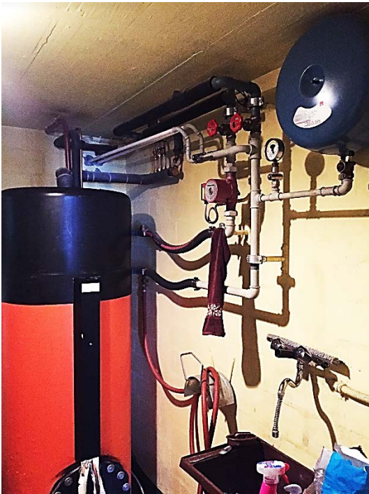
Die bestehende Wärmepumpe
