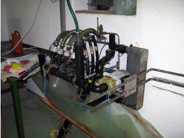
Der alte Erdsondenverteiler
