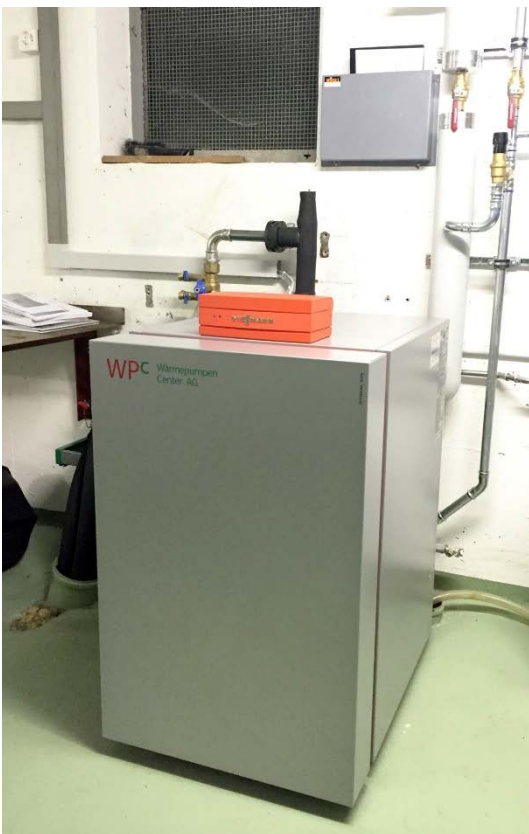
Neue Viessmann- Wärmepumpe
