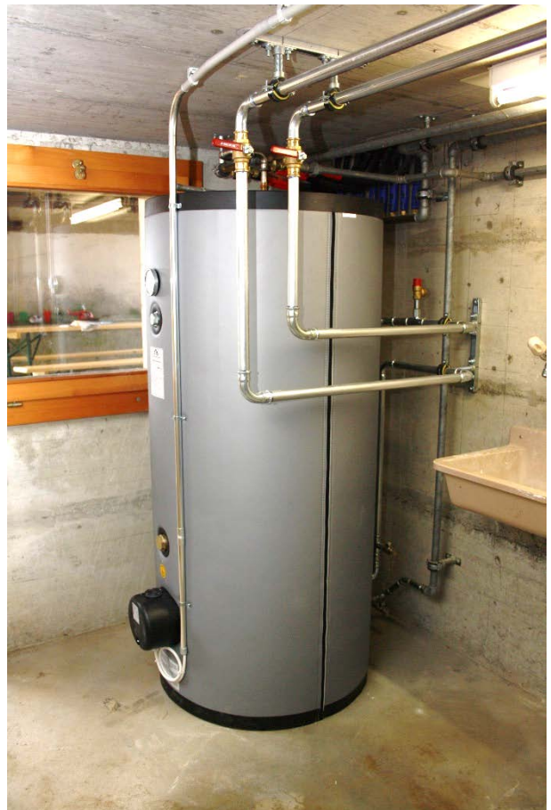
neuer Boiler mit externer Ladung
