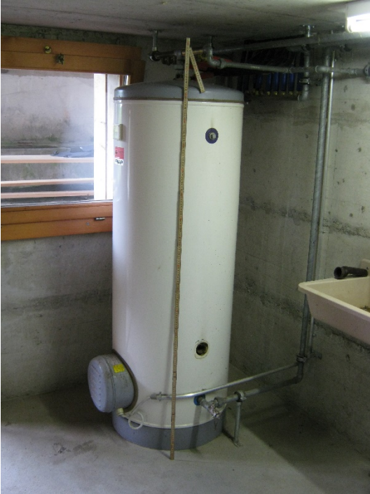
Der alte Boiler steht im Waschraum
