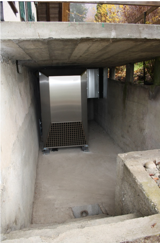
Die Wärmepumpe im Aussenbereich
