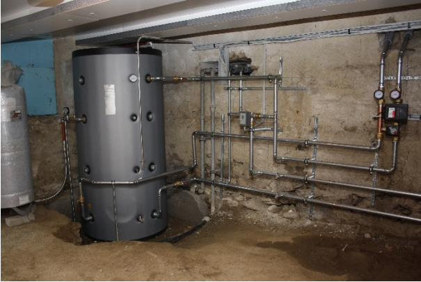
Speicher und Verrohrung im Naturkeller
